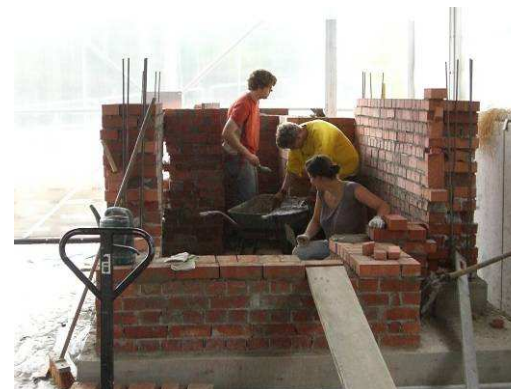
Aufbau der Pilotanlage
