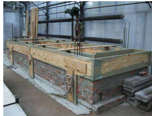
Aufbau der Pilotanlage
